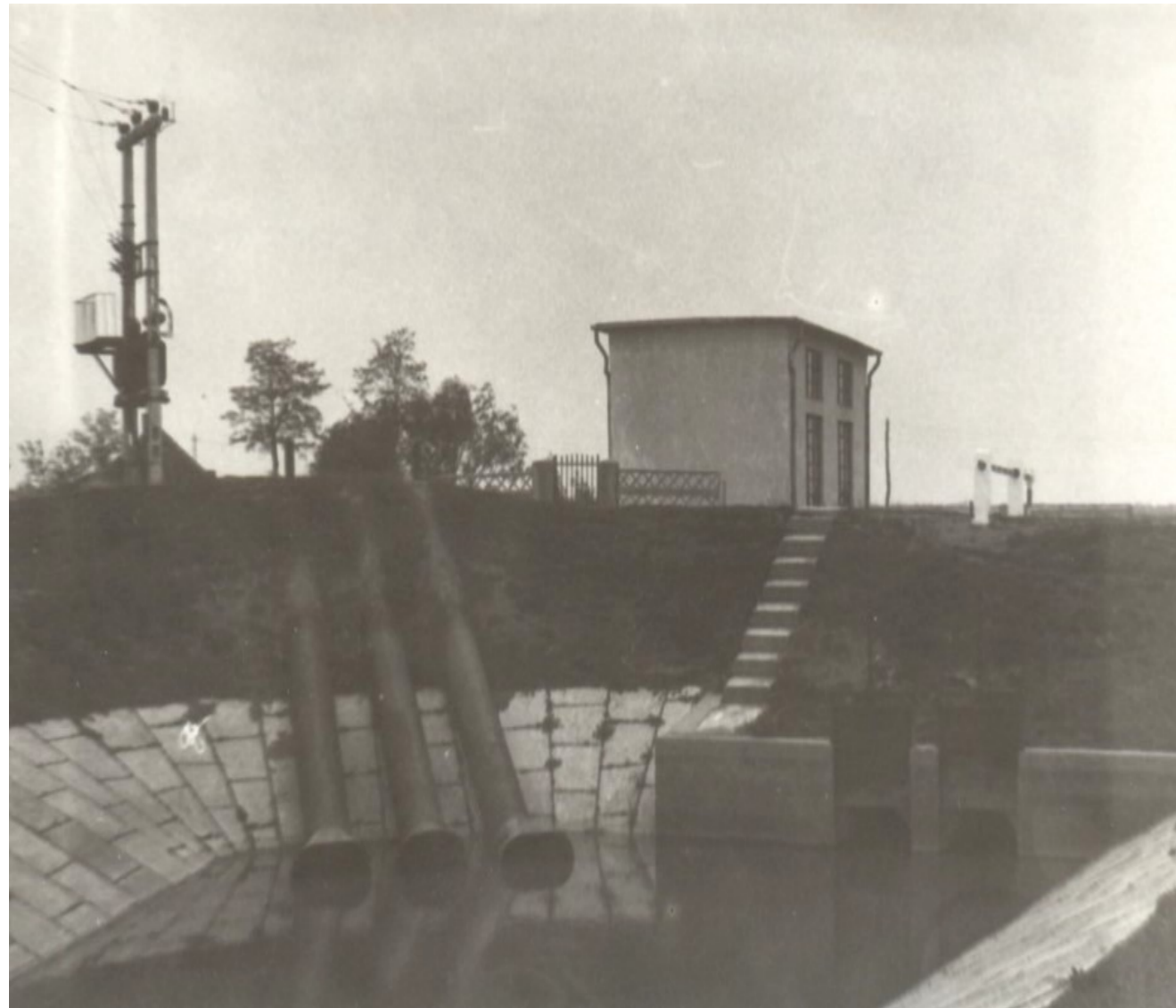
Stația de pompare a apei termale 1971
